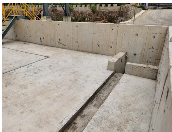
储罐区围堰内部设置导流槽及收集池
